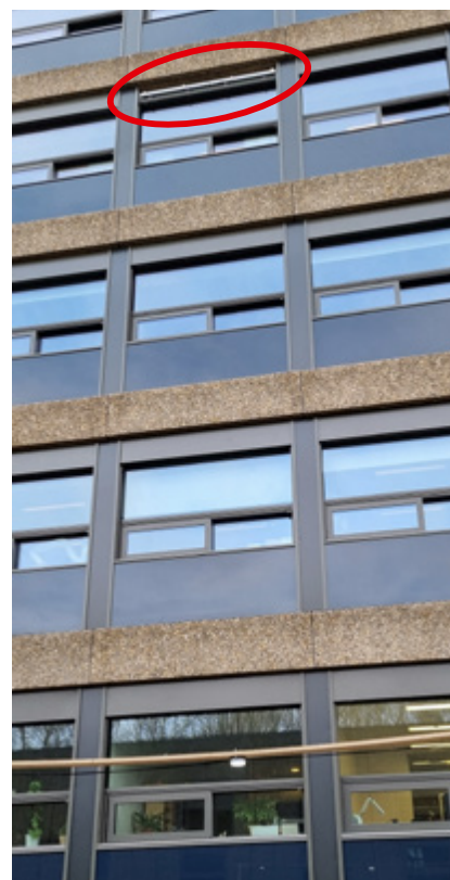
Pladen faldt ned fra 4. sals højde og 14 dage efter under stormen »Malik« faldt yderligere 14-15 plader ned.
